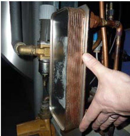
Lämmöntalteenoton lämmönvaihdin eli lämmöntalteenottopakka eli levylämmönsiirrin.
