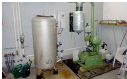
Tyhjöpumppu (vihreä) ja taajuusmuuttaja (valkoinen kotelo seinällä).
